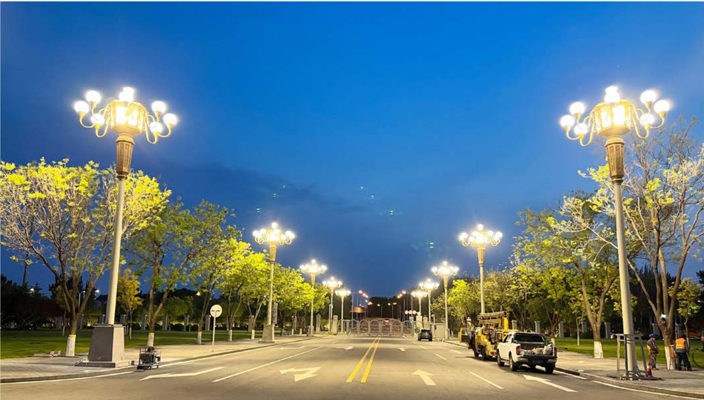
首都机场贵宾楼照明工程
